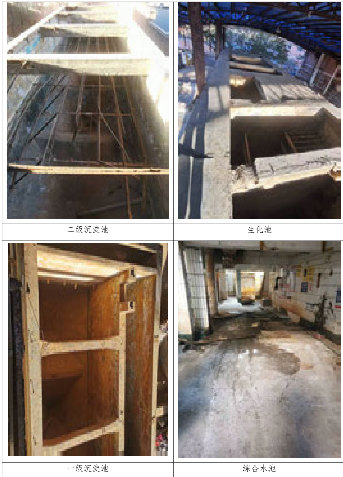
图3.5-1 废水站各池体图片
