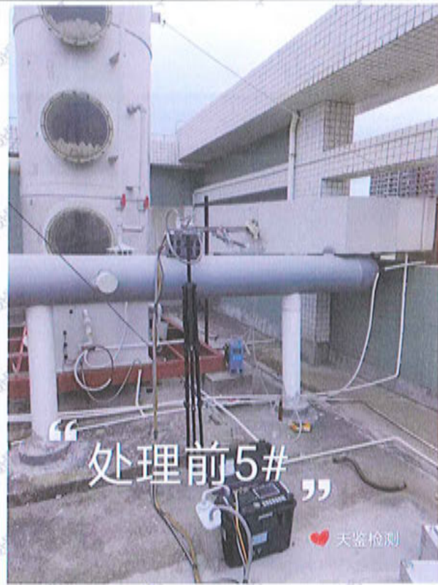
5#排气筒处理前检测口
